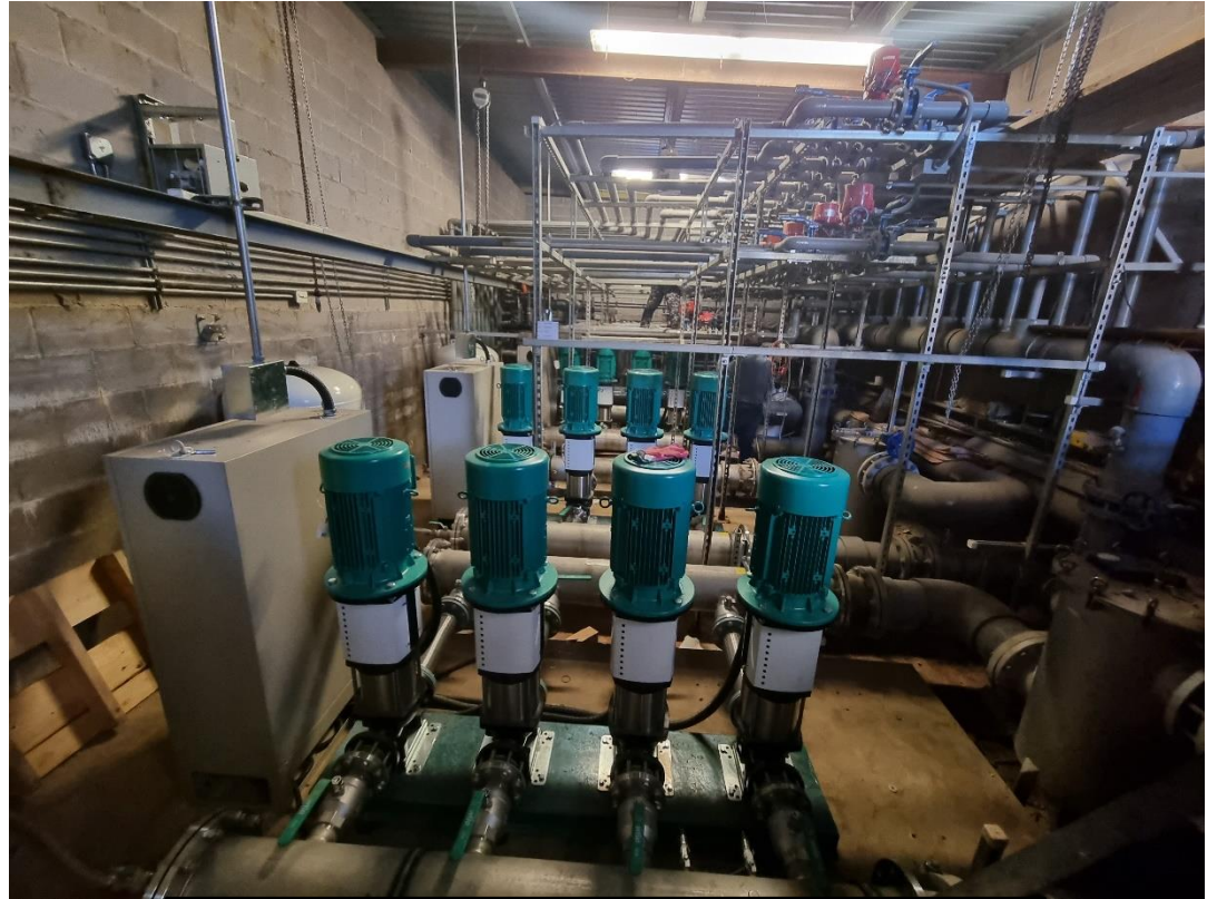
수영장용 부스터펌프 설치(지하) 사진
